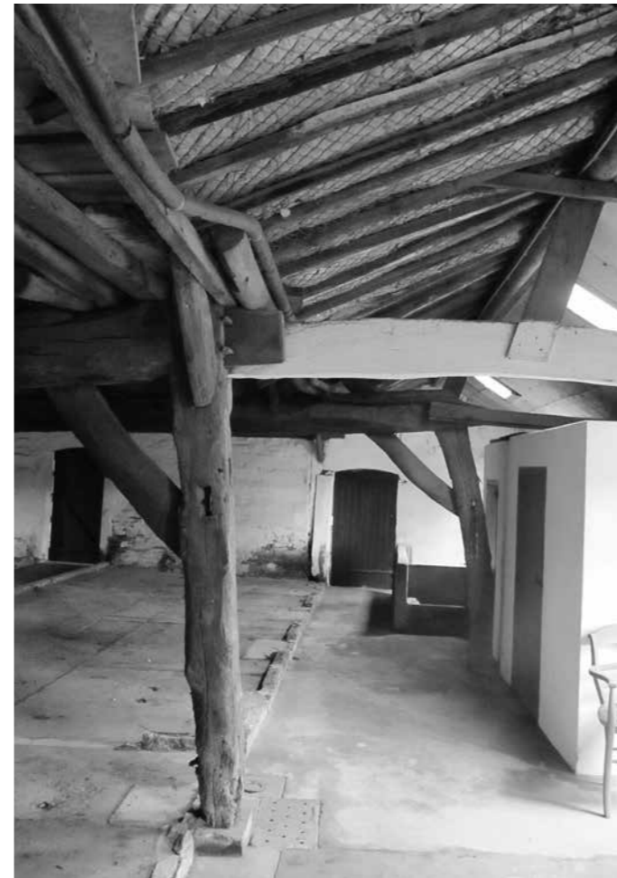
Op de voorgrond de oostelijke stijl van gebint 3. Verder naar achter de kreupele stijl van het nieuwe vierde gebint. Op de achtergrond in de scheidingmuur is het oude gebint nummer 4 ingemetseld. (foto: Jan Timmers)
